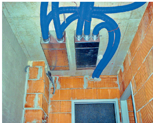
Detail zakázkových rozdělovačů EDF-M-BOX v suterénu budovy
